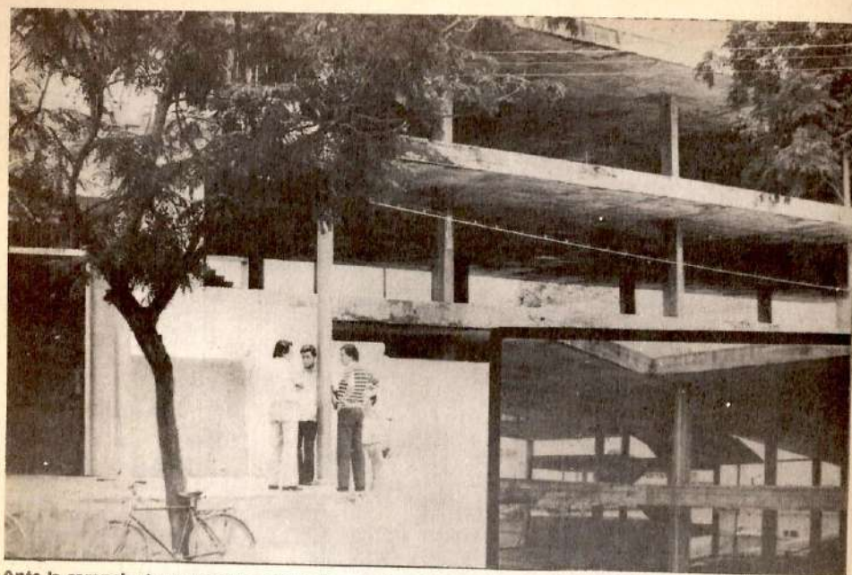
Ante la carencia de un edificio adecuado para las oficinas municipales, se está adelantando a pasos rápidos la construcción de lo que será la sede de las dependencias oficiales de El Espinal. En la gráfica, directivos de la revista TOLIMA dialogan con el alcalde Humberto Rodríguez Góngora. En el recuadro, otro aspecto de la obra. (Composición con fotos de Campuzano y G.H.C.)
