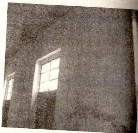
Filtraciones sobre las paredes
