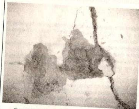
Detalle en la fractura del muro de tapia pisada
